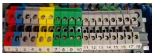
شکل 6: ترمینال‌های اتصال الکتریکی
